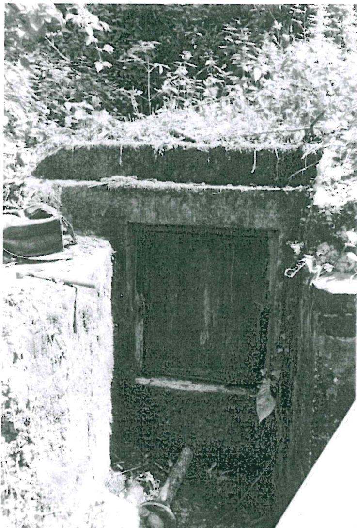
Foto 11 - Sorgente Corsinelli Bassa Il bottino di presa in alveo del torrente.
