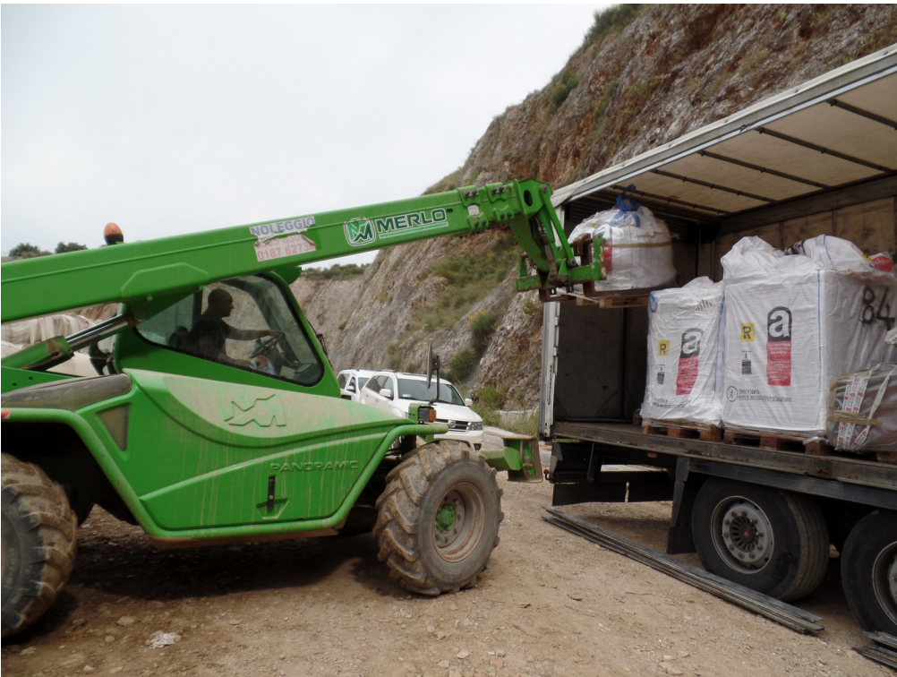
Foto 4: scarico RCA su pallet
